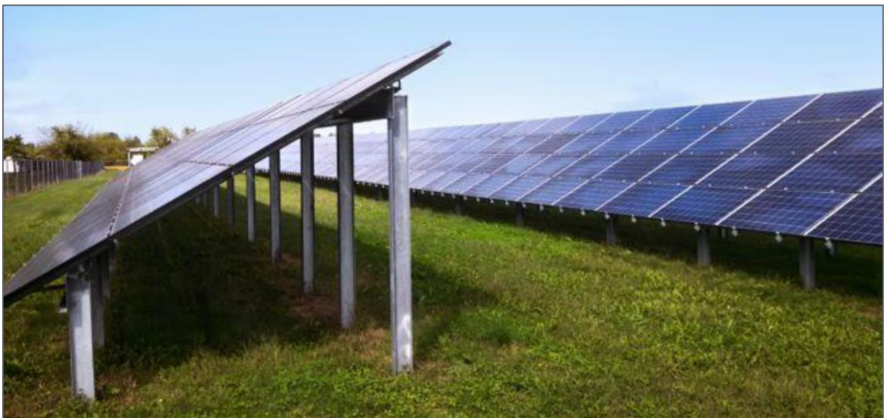
Figur 3-2: Eksempel på fast-vinkel installasjonsløsning (foto: Willowbrook Solar)
